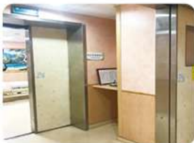
厚鉛隔離防護門板 / 物品傳遞區
